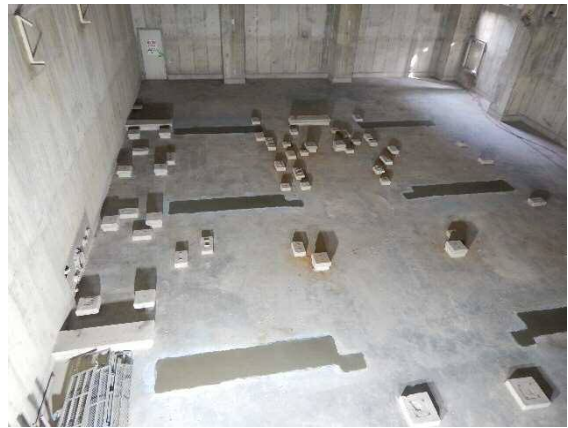
写真③ 4F 脱気機室後状況
